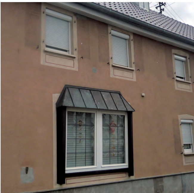
Negativbeispiel: nachträglich eingefügtes, unpassendes Fenster
