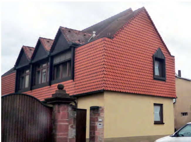
Negativbeispiel: Untypische Deckung und Dachgestaltung
