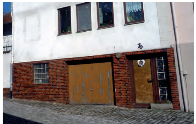
Negativbeispiel: Erdgeschoss mit Fliesenverkleidung
